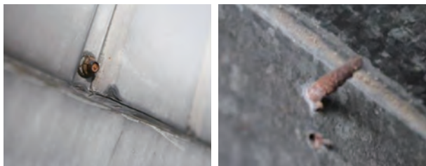
▲ 图2 10年后螺钉头部和螺杆螺纹部分均已锈蚀
