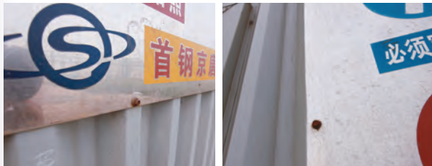
▲ 图1 曹妃甸某项目墙面镀锌螺钉12个月内出现锈蚀
