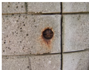
▲ 图5 碳素钢螺钉粉碎性锈蚀
